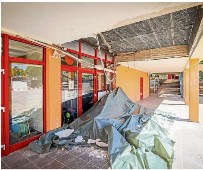
An der Astrid-Lindgren-Schule in Marburg hat es Ende Mai am Verbindungsgang zum Schulhof einen Teileinsturz der Decke gegeben. Foto: Thorsten Richter
