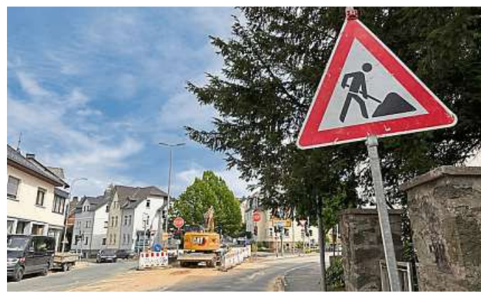
Nach dem Wasserrohrbruch laufen am Montag die Reparaturarbeiten an der Kreuzung Stoppelberger Hohl/Nauborner Straße. Foto: Tanja Freudenmann
